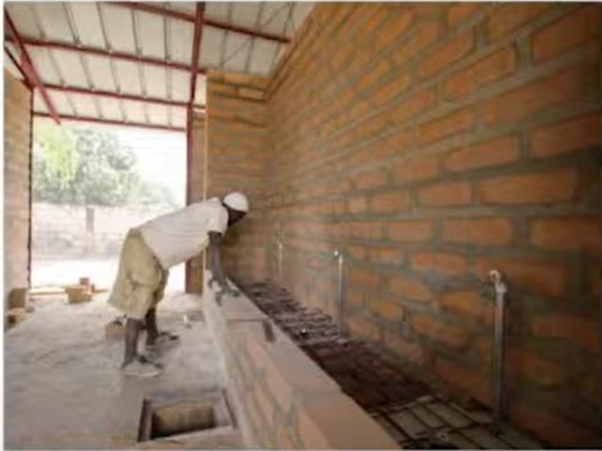
// Sanitarije s tekočo vodo, ki je napejана iz vodnjaka na parceli // Lavatories with running water from the "borehole" on the site
