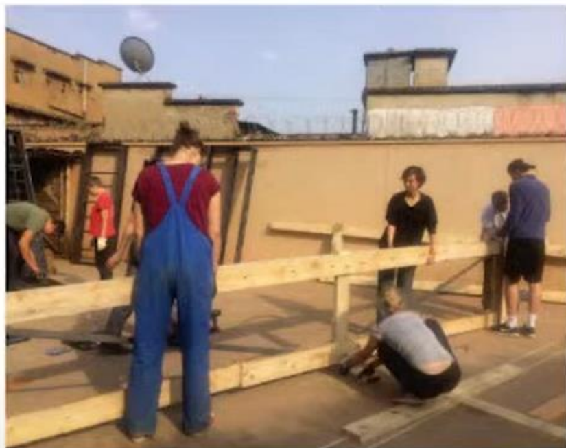
// Izdelava strešnih nosilcev na dvorišču hosta, kjer smo prebivali // Making of timber roof trusses in the courtyard of the hostel where we stayed
