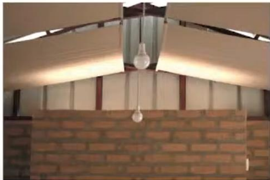
// Tekstilni strop z odprtim sklenjskim delom za zračenje in preprečevanje pregrevanja notranjosti // Textile ceiling with open top for ventilation and prevention of overheating
