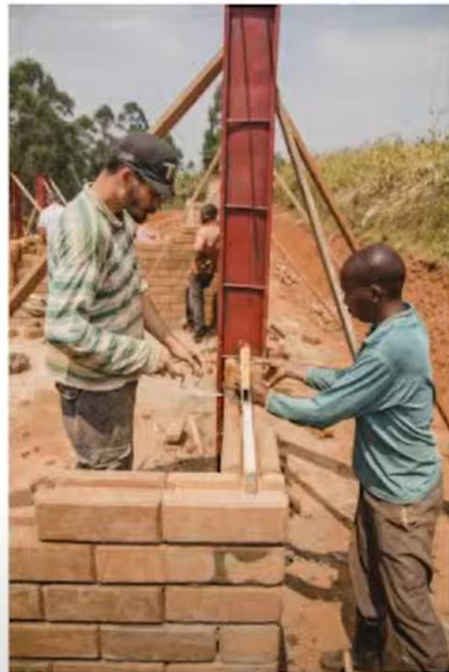
// Zidanje in ojačevanje v vogalih (železnični trakovi) // Bricklaying and corner reinforcement (steel bands)
