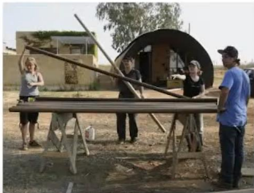
// Izdeleva stropnih panelov iz kartonskih tulcev // Making of cardboard tubes panels for ceiling
