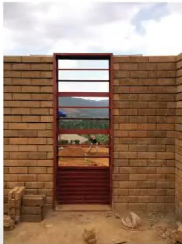
// Ovkanski okvirji: stabilizirajo opečne stene, nudijo poglede in omogočajo zračenje // Window frames: stabilize brick walls, open views and enable ventilation
