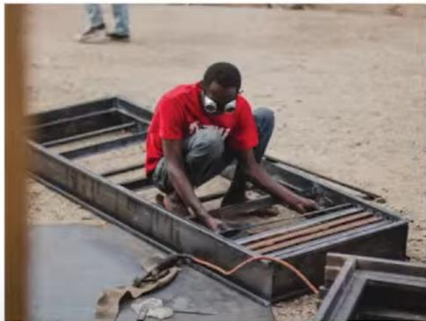
// izdelava jeklenih okenskih okvirjev v lokalnem kovinarskem obratu // Making of steel window frames in local workshop
