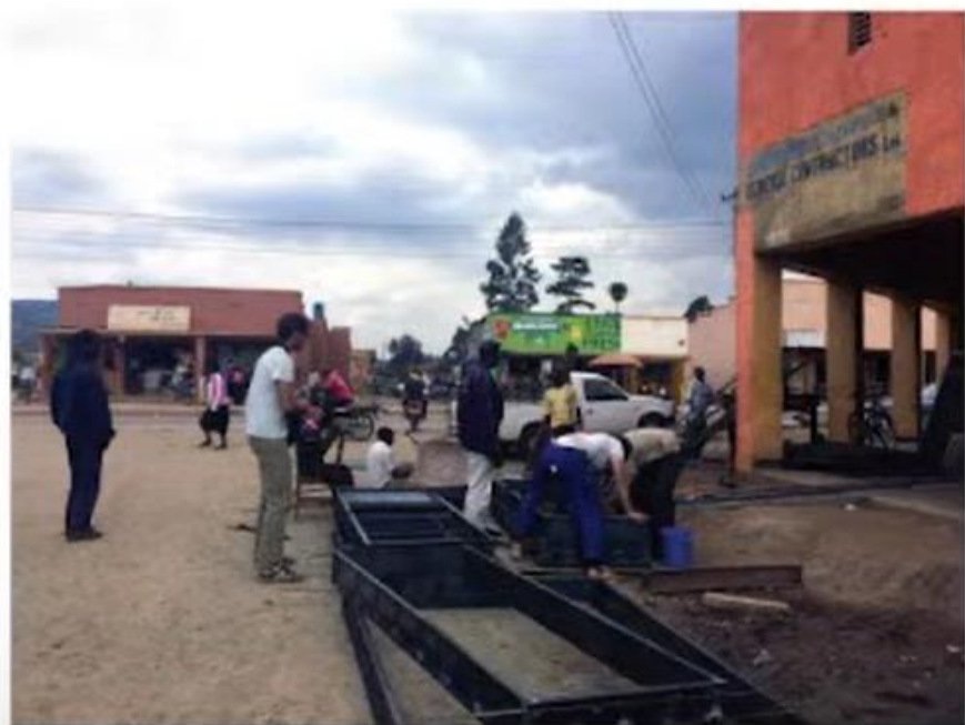
// Izdelava jekasnih okenskih okvirov v lokalnem kovinarskem obratu v sodelovanju študentov in lokalnih delavcev // Making of steel window frames in local workshop in cooperation of students and local workers
